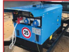
GE entièrement intégré à l'unité
